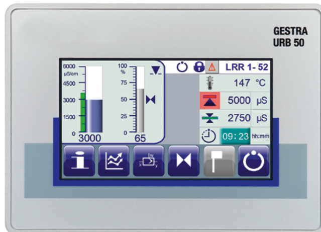
Gestran kattila-automaation operointipaneeli. Näytössä on nähtävissä helposti höyrykattilan tärkeimmät arvot ja ovatko arvot sallituissa rajoissa.
