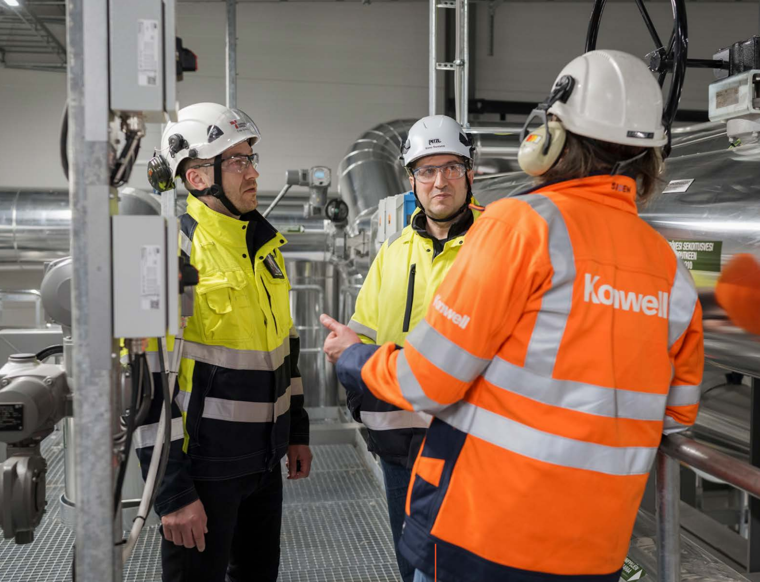
Tampereen Energian Erkki Suvilampi ja Simo Suolahti sekä Konwellin Ville Autio tutustumassa Lielahden sähkökattilalaitoksen prosessitiloihin.
